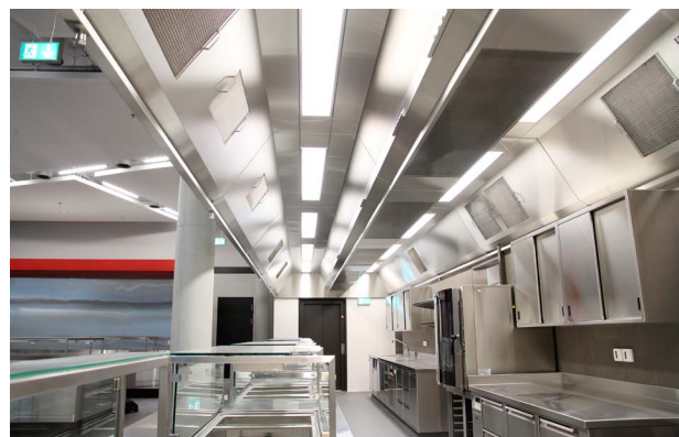
... zum eingebauten Modul.
